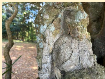
（写真2）石材の剥落・欠損
