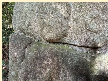
（写真3）割れの応急処置
